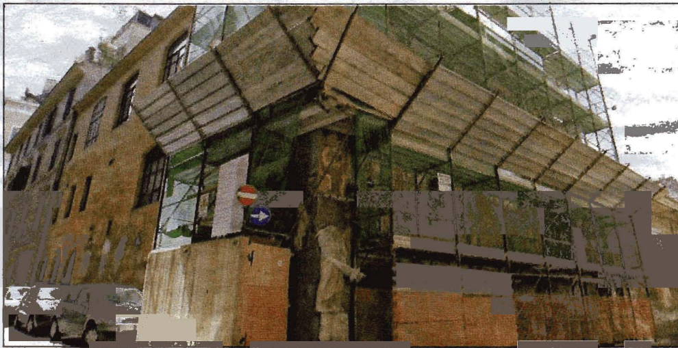
Lo studio che è stato di Antonio Canova circondato dai ponteggi del cantiere di restauro
